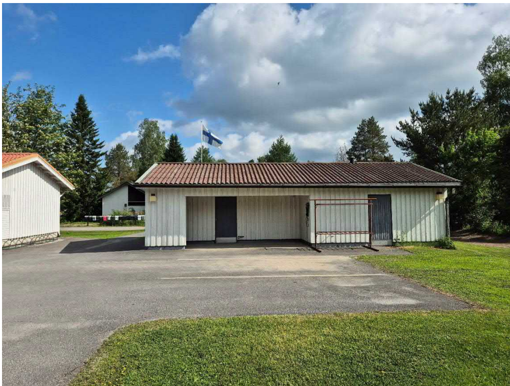
Kuva 2. Myös varistorakennuksen vesikate sisältää asbestia.
