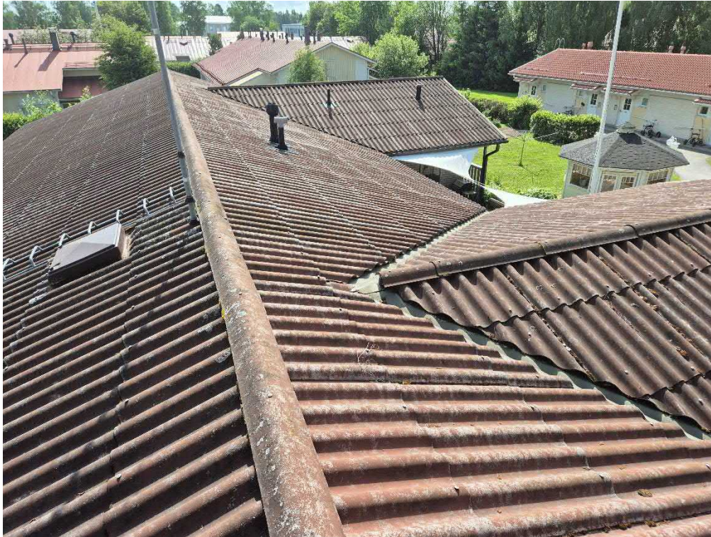
Kuva 1. Vesikate sisältää asbestia.
