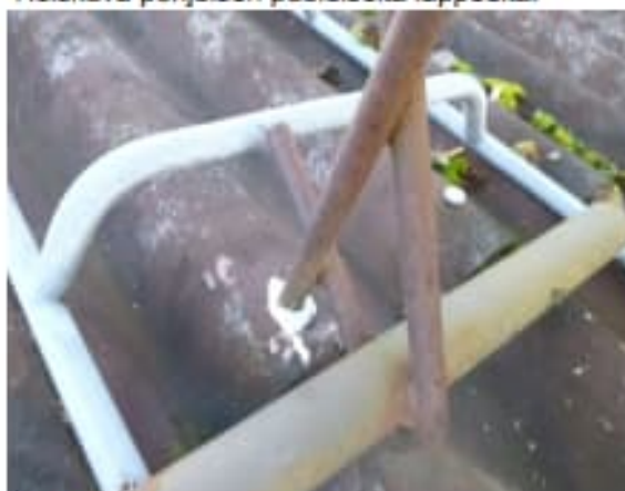
Kuva 118 Lumiastian kiinnitysaukko on tiivistetty massalla.
