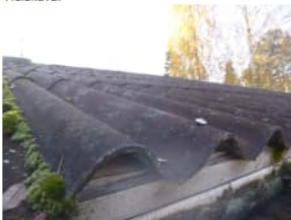
Kuva 117 Katteella on sammalta, merkittäviä halkeamia ei ole.
