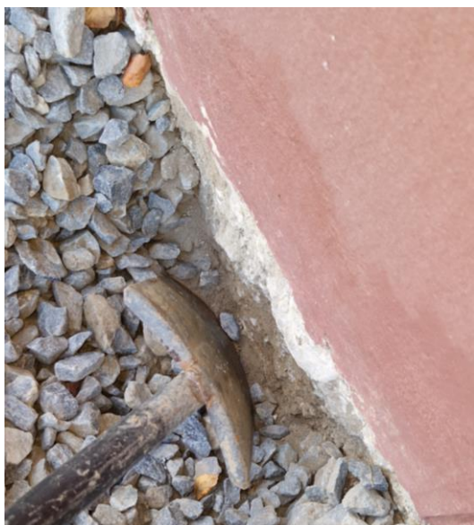
Kuva 11 Sokkelissa ei ole ulkopuolista veden- ja lämmöneristettä (50-luvun osa).
