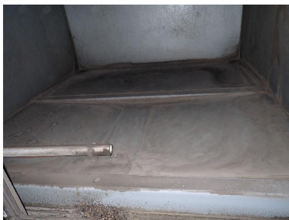
Kuva 139 Raitisilmakammiossa likaa ja vähäisiä kosteusjälkiä. Kammiossa on vedenpoisto.
