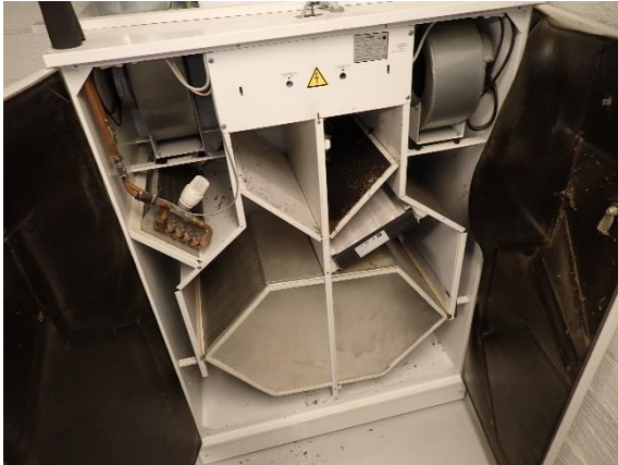
Kuva 152 TK5/PK5 ilmanvaihtokone avattuna.
