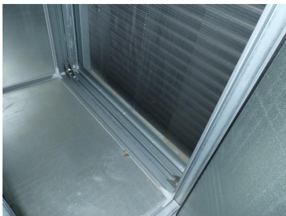
Kuva 140 Koneen TK-2 sisäosat ja lämmityspatteri ovat puhtaita.
