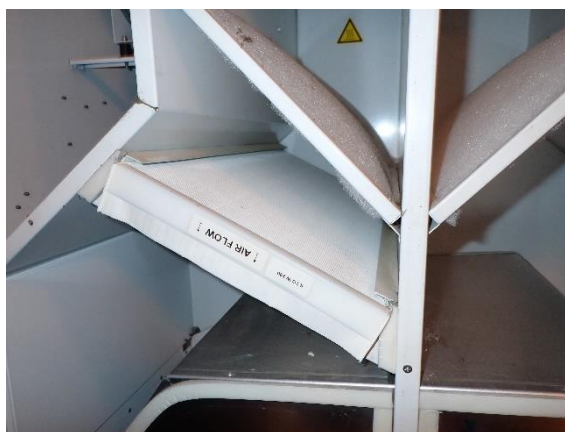
Kuva 159 TK6/PK6 tuloilman suodattimet.
