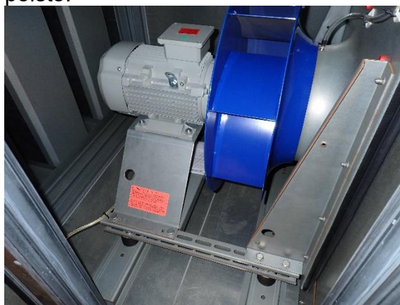
Kuva 141 TK-2 puhaltimet ovat alkuperäisiä kammiopuhaltimia.
