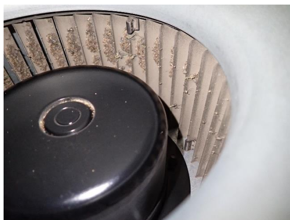
Kuva 155 TK5/PK5 puhaltimien siivekkeissä lika-kertymää.
