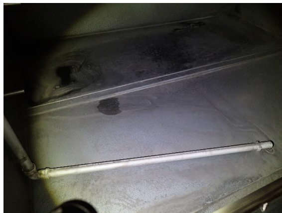
Kuva 131 Raitisilmakammiossa hieman likaa ja kosteusjälkiä.
