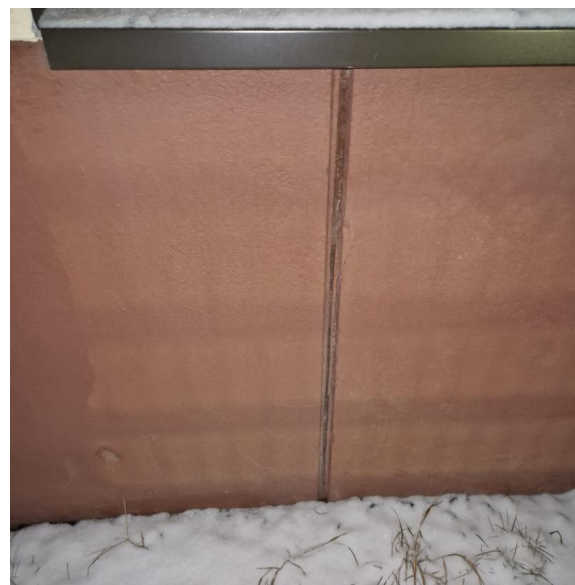
Kuva 12 Eteläpuolen sokkelissa on avoin saumakohta, josta voi päästä vettä seinärakenteeseen.
