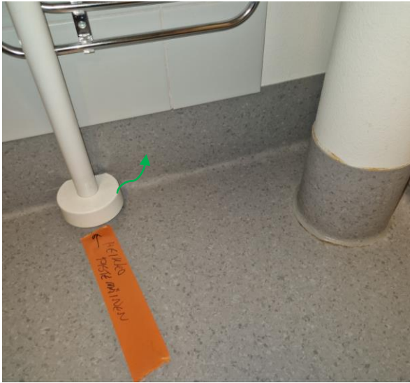
Kuva 45 Vuoden 2011 laajennuksen lääkärin huoneessa havaittiin heikko pistemäinen vuotokohta viemärin läpiviennin kohdalla.
