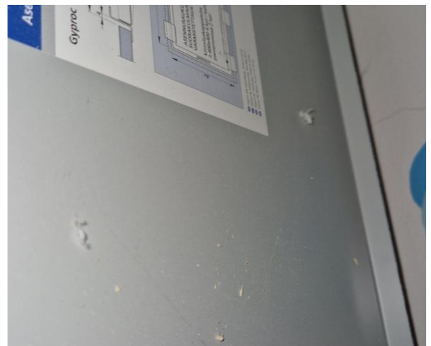
Kuva 119 Tarkastusluukun kannessa oli puhalluseristeen jäämiä. Puhalluseristettä pääsee yläpohjasta läpivientiä kautta sisätiloihin.
