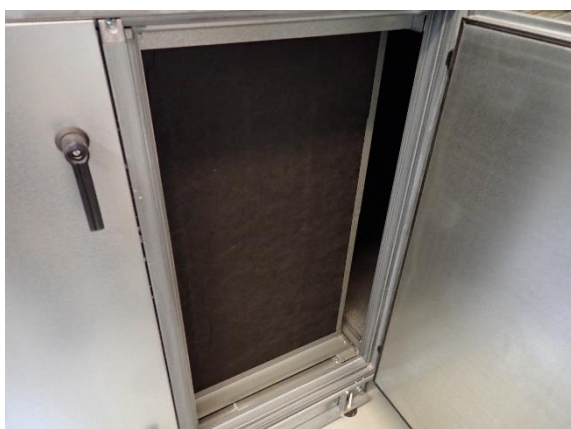
Kuva 134 Koneessa olevat äänenvaimentimet on suojattu, eikä niissä ole mineraalivillakuitujen lähteitä.
