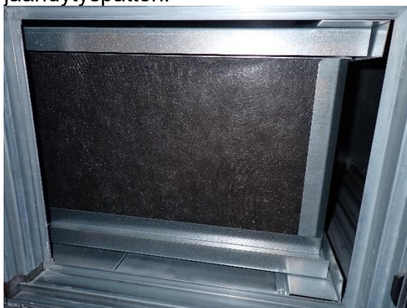
Kuva 151 Äänenvaimentimien pinta on suojattu.
