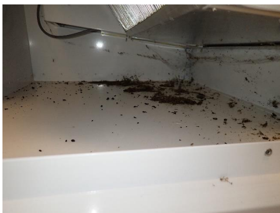
Kuva 156 Koneen sisäosissa likaa ja roskaa.
