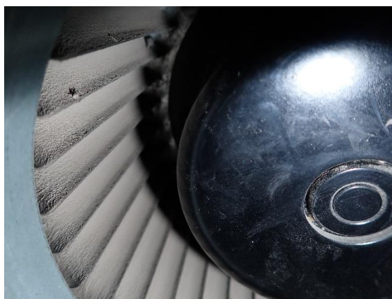
Kuva 161 Poistopuhaltimen siivekkeissä pölyker-tyymää.
