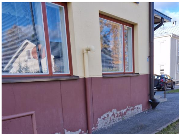
Kuva 7 Kattovedet on ohjattu rännikaivoihin. 50-luvun osan sokkelirakenteissa näkyy kosteusrasituksesta johtuvia jälkiä.
