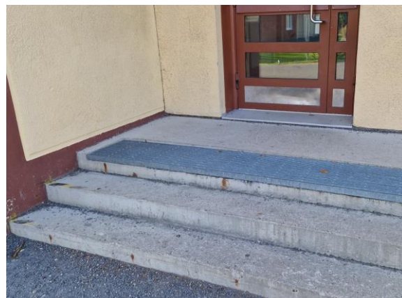
Kuva 10 Pohjoispäädyn laajennusosan sisäänkäyntiportaat eivät kaada ulospäin ja sade- ja sulamisvesiä voi ohjautua sokkeliä päin.
