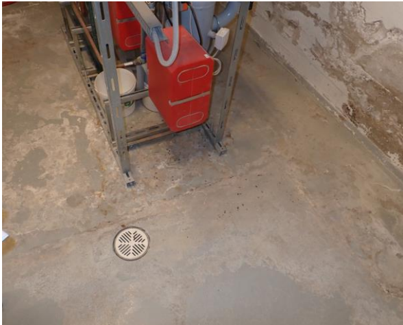
Kuva 37 Lämmönjakotilan rakenteissa näkyy kosteusrasitus.
