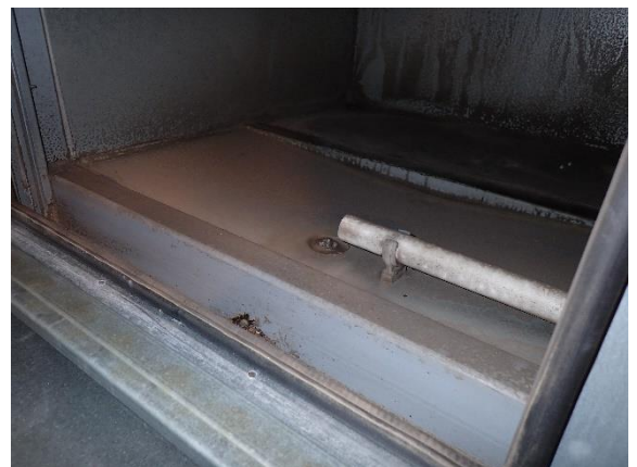
Kuva 144 Raitisilmakammio lievästi likaantunut. Kammiossa on vedenpoisto. Suodattimien kiinnitys on tiivis.
