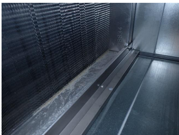
Kuva 149 Kone on sisäosilta puhdas. Kuvassa jäähdytyspatteri.
