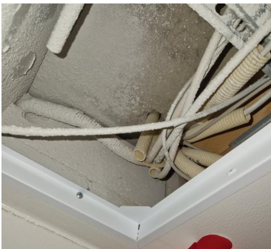
Kuva 118 Vuoden 2011 laajennusosan yläpohjaan on epätiivitä läpivientiä. Yläpohjan puhalluseristettä voi kulkeutua sisätiloihin.
