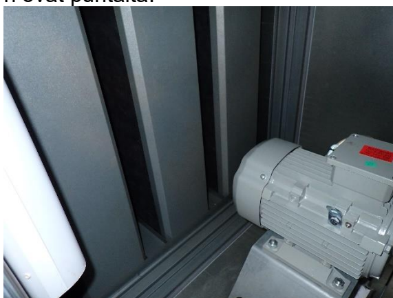
Kuva 142 TK-2 äänenvaimentimet on suojattu.
