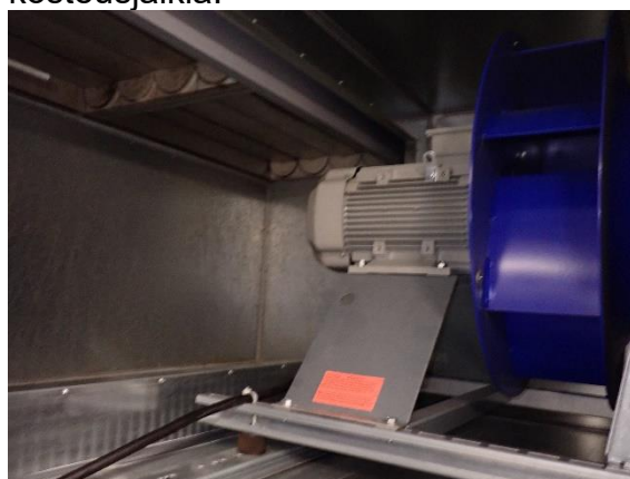
Kuva 133 TK1/PK1 puhaltimet ovat alkuperäisiä kammiopuhaltimia. Poistopuhaltimen ääni viittaa laakerivikaan.
