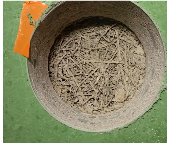
Kuva 40 Rakenneavaus AP2. Toja-levyn pinnassa näkyy vähän tummentumia.
