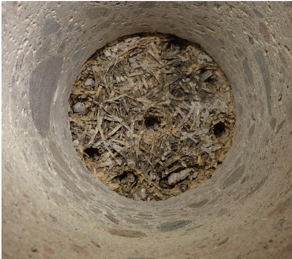
Kuva 39 Rakenneavaus AP1. Toja-levyn pinnassa näkyy tummentumia.
