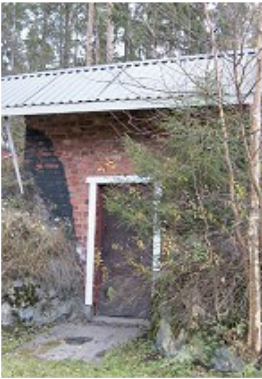
Kellarin vesikatto on myöhempää lisäystä. Kuvaaja: Tiina Lehtisaari. Kuvausaika: lokakuu 2004
